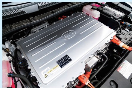
图 3-6 实车上的电池
