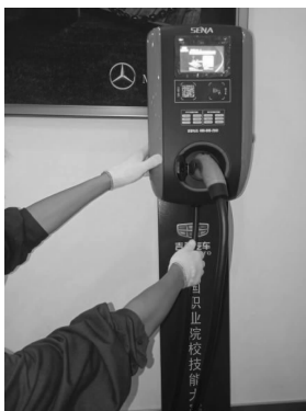
图 1-26 充电设备的检查
