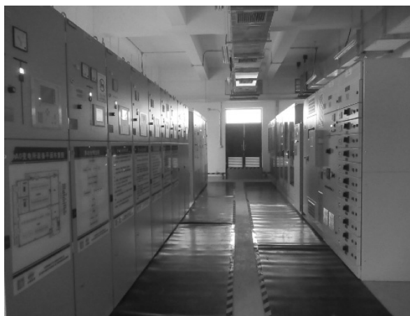
图 1-17 企业变电所的室内部分
