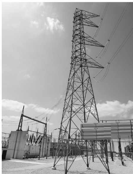
图 1-15 高压配电所室外部分
