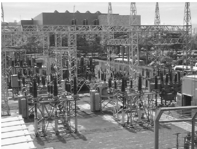
图 1-14 总降压变电所
