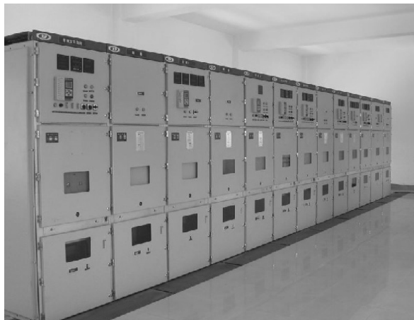
图 1-16 高压配电所室内部分
