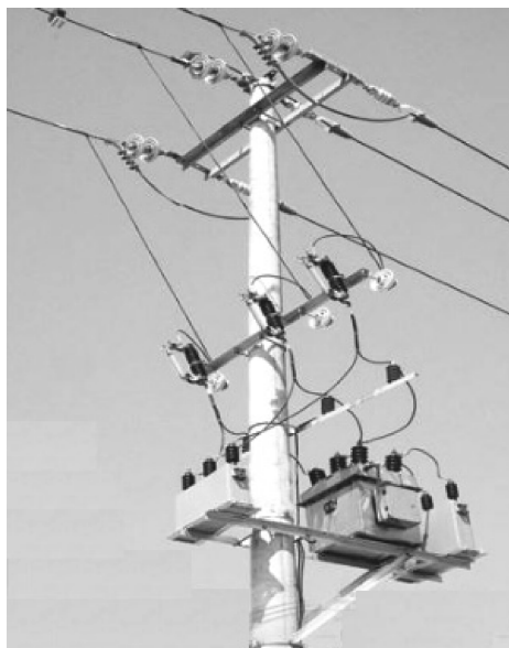
图 1-18 企业变电所的室外下线部分
