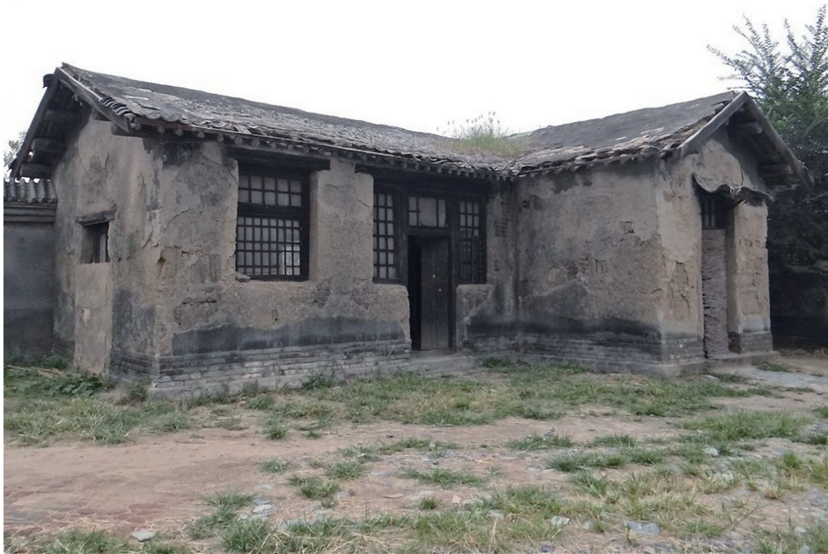
图 1-7 破旧房屋照片素材
